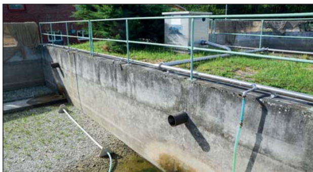
Obr. 9 – Dodatečné vybavení sádek centrálním rozvodem stlačeného vzduchu (stříbrné trubky) a aeračními válci (šedá tyč na dně sádky). Jako zdroj vzduchu slouží výkonná dmyhadla fy. Kubáček s regulací výkonu, která jsou umístěna v krytých boxech (uprostřed nahoře) (foto J. Regenda)
