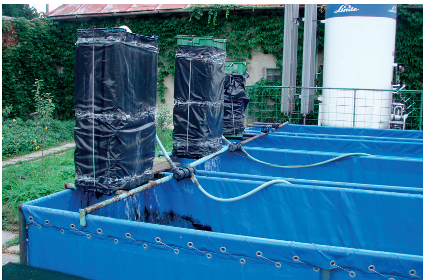
Obr. 16. Zkrápěné filtry (sestavené z plastových bedniček na ovoce naplněných plastovými šponami, obalené černou fólií, instalované pro každý odchovný žlab samostatně). Vpravo vzadu zásobník na tekutý kyslík. Foto J. Kouřil.
