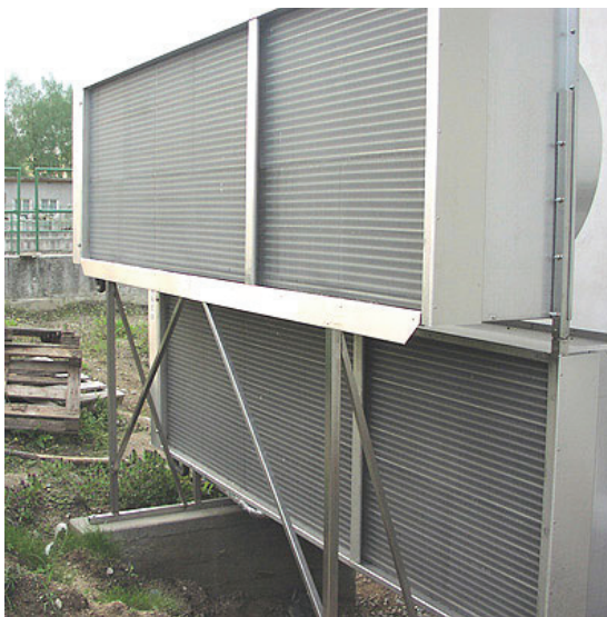
Obr. 10. Venkovní vzduchové výměníky
