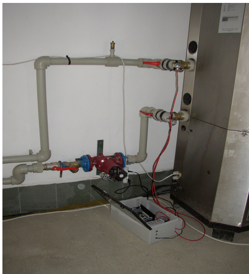
Obr. 9. Ukázka instalace měřicího systému k tepelnému čerpadlu v N.Hradech
