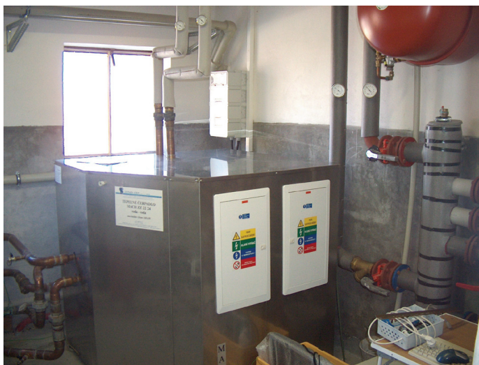
Obr. 8. Ukázka instalace tepelného čerpadla v Pohořelících
