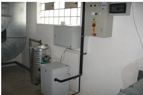
Obr. 11. Malé tepelné čerpadlo s primárním výměníkem topení ve Vodňanech
