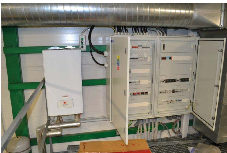
Obr. 15. Elektrický kotel na ohřev vody a rozvodná skříně s termostatem (Foto: J. Hampel).
