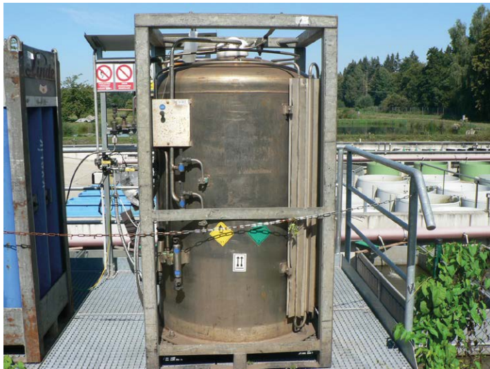
Obr. 13. POS nádrž o objemu 600 litrů na skladování hluboce zmrazeného kyslíku, který slouží jako zdroj plynného kyslíku využívaného v intenzivním chovu ryb (Foto: T. Polícar).
