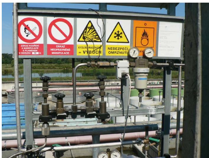
Obr. 14. Redukční stanice TLS O22, která slouží k transformaci hluboce zmrazeného kyslíku na plynný kyslík (Foto: T. Polícar).
