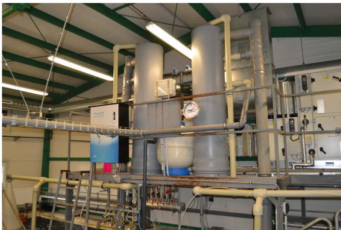
Obr. 10. Pohled na distribuční nádrže obou provozovaných RAS (Foto: J. Hampl).
